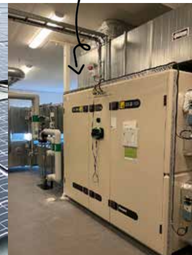
VENTILATIONSAGGREGAT I ETT FLÅKTRUM
